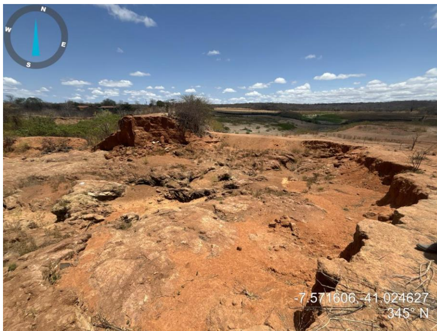
FOTO 01 – PONTO DE RUPTURA DO EIXO DE BARRAMENTO
