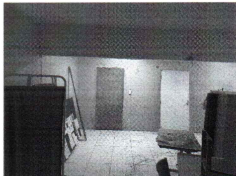
EXECUÇÃO DE FECHAMENTO DE VÃO COM BLOCOS CERÂMICOS, CHAPISCO, EMBOÇO E REBOCO
