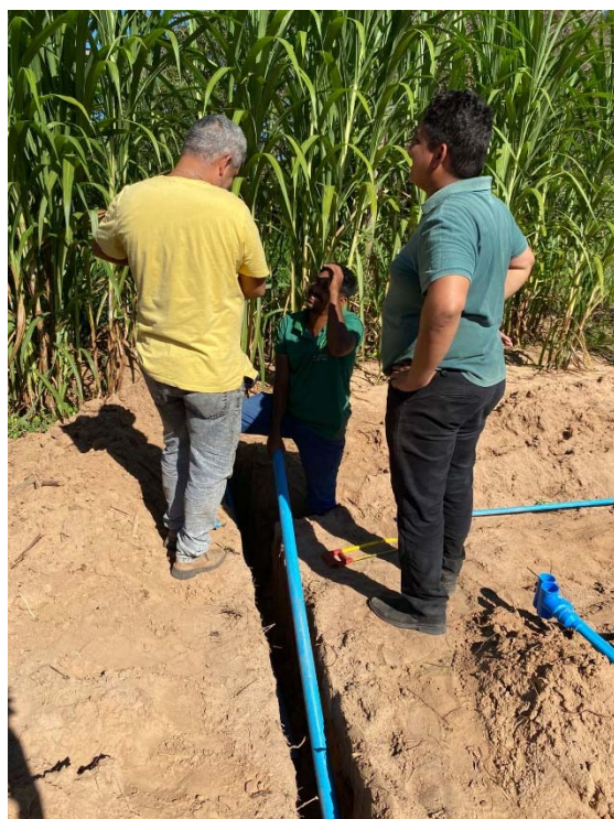
Figura 5 – Implantação estrutural de tubulações para microaspersão no campo.
