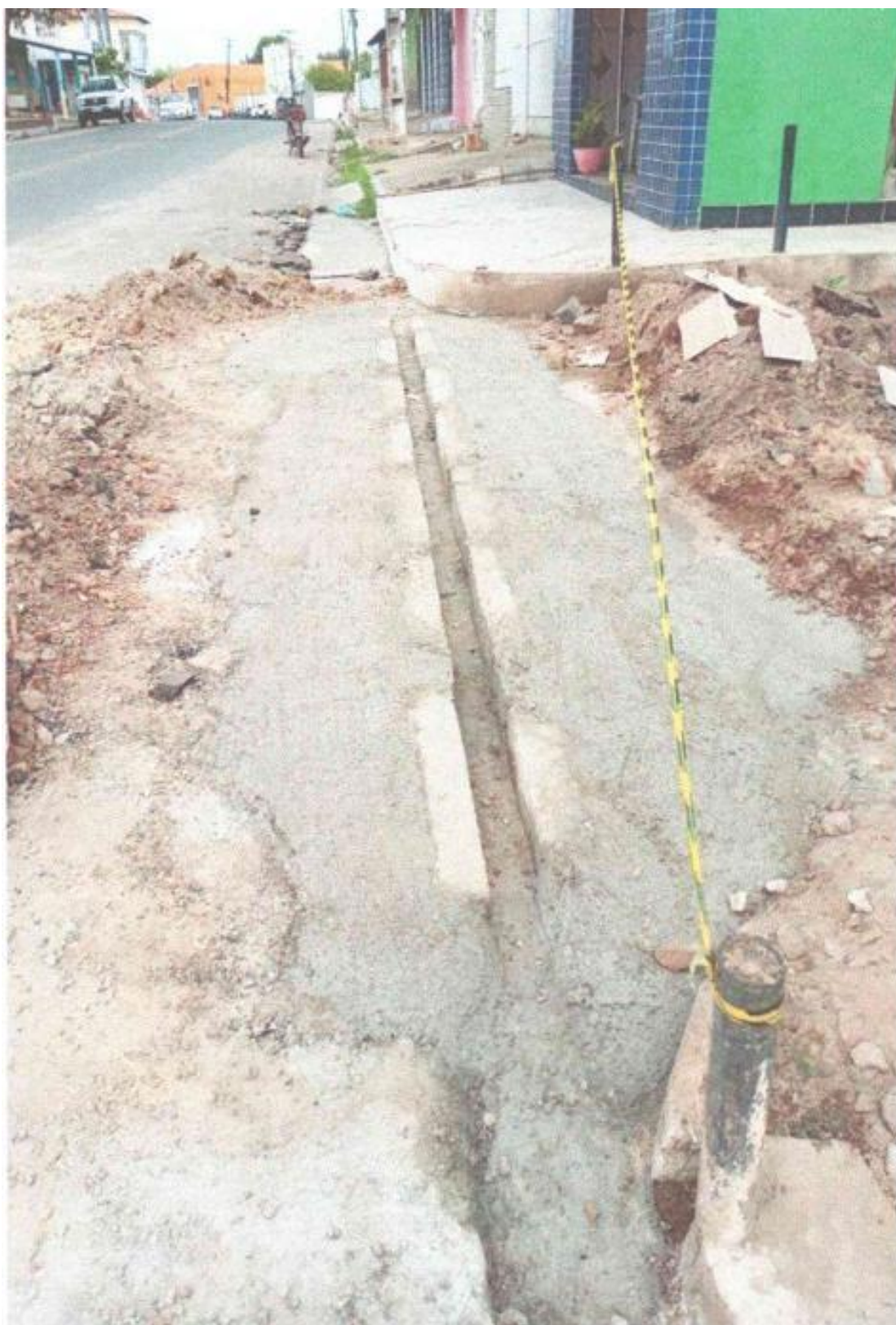
Canaleta Rua Arão Lobão
